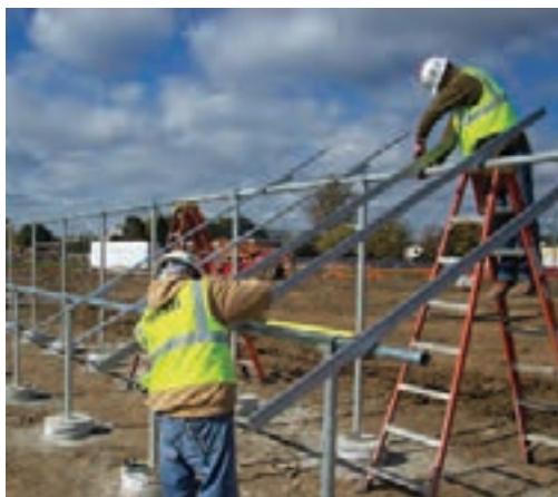
تصویر ۱۱ - سیستم های فتوولتائیک نصب شده بر زمین
